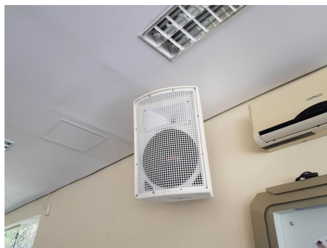
Figura 6 - Caixas de som da Nave
