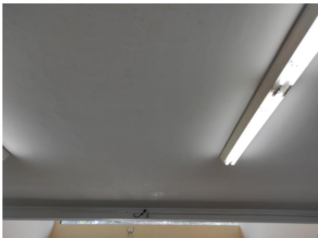
Figura 13 - Forro em gesso acartonado, atenua o ruído entre pavimentos
