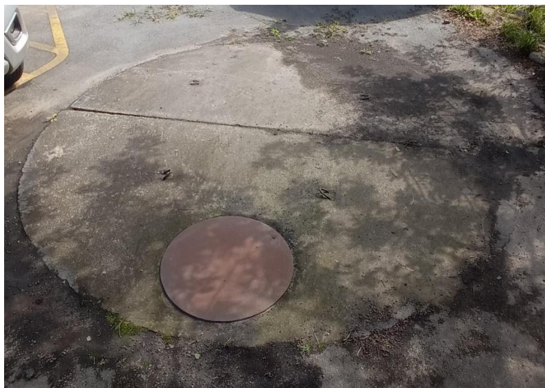
Figura 29: Fossa no interior do empreendimento. Fonte: Master Ambiental, 2022.
