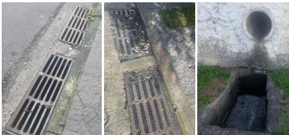
Figura 35: Sistema de drenagem na AVM. Fonte: Master Ambiental, 2022.
