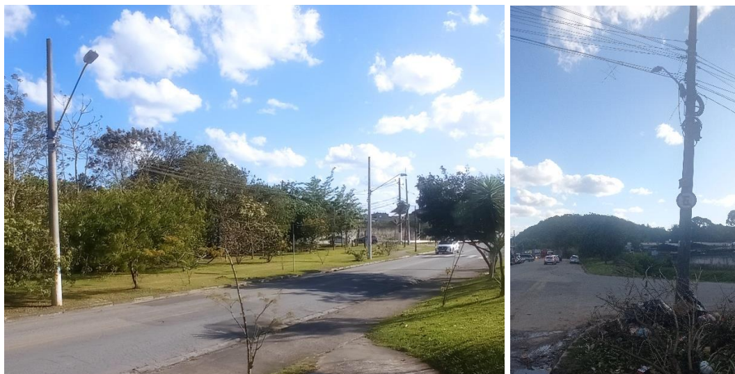
Figura 27: Iluminação pública na AVM. Fonte: Master Ambiental, 2022.
