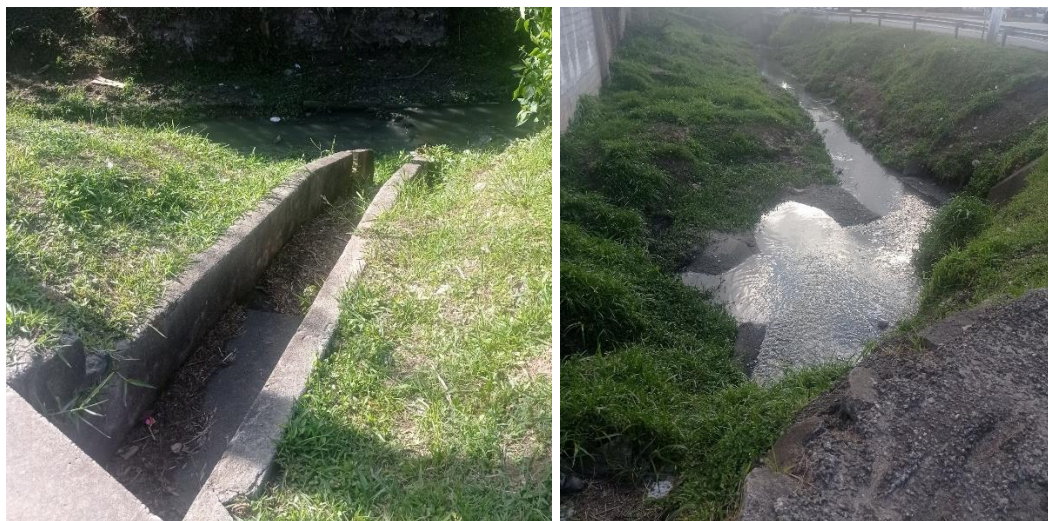
Figura 33: Sistema de drenagem na AVM. Fonte: Master Ambiental, 2022.
