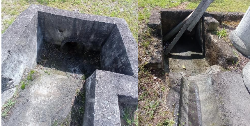
Figura 32: Sistema de drenagem nos lotes do empreendimento. Fonte: Master Ambiental, 2022.
