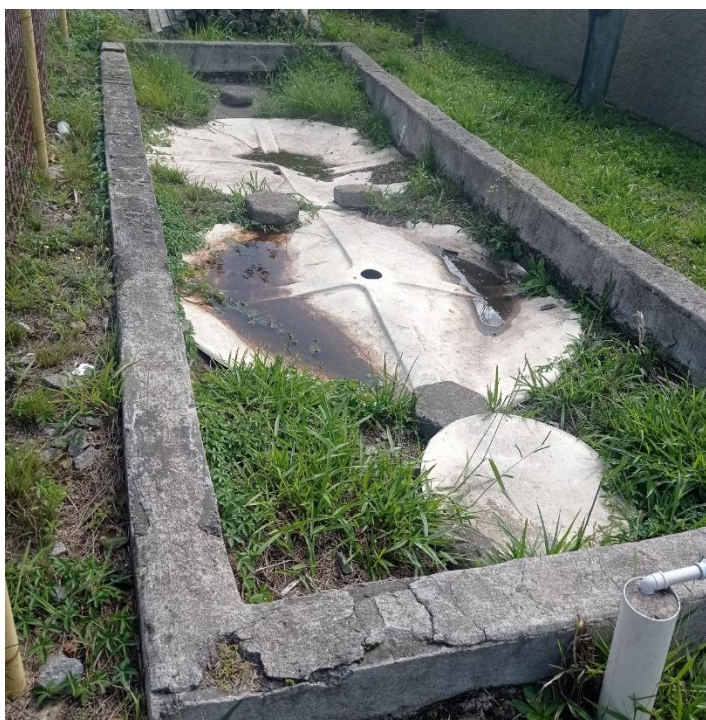
Figura 28: Fossa séptica no interior do empreendimento. Fonte: Master Ambiental, 2022.
