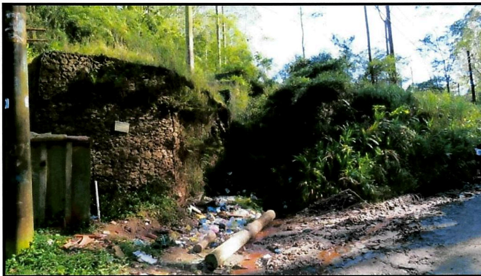
Foto 18: Visada do limite terreno com vizinhança na estrada Montanhão, indicando acúmulo de resíduos e água parada. Apresenta ambiente propício para animais sinantrópicos nocivos.
