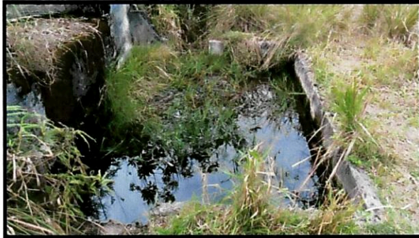
Foto 17: Indicação de caixa de drenagem com acúmulo de água, potencial sítio para reprodução de mosquitos (como dengue).
