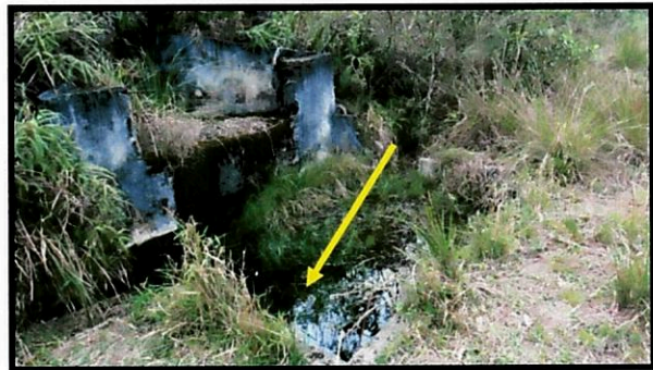
Foto 16: Apresenta mais ruínas de sistema de drenagem, indicando caixa com grande volume de água
