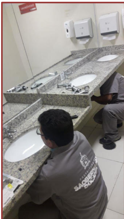
Figura 13 – Instalação de torneira de fechamento automático tipo mesa em unidade escolar
