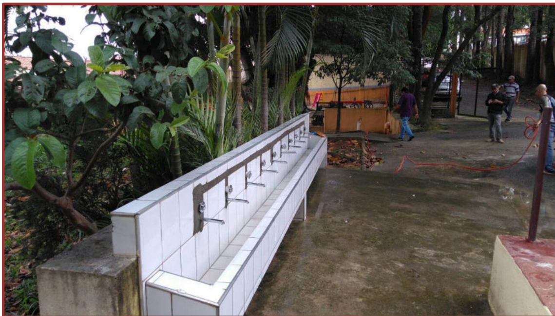
Figura 18 – Instalação de torneira de fechamento automático tipo parede – antivandalismo em unidade escolar
