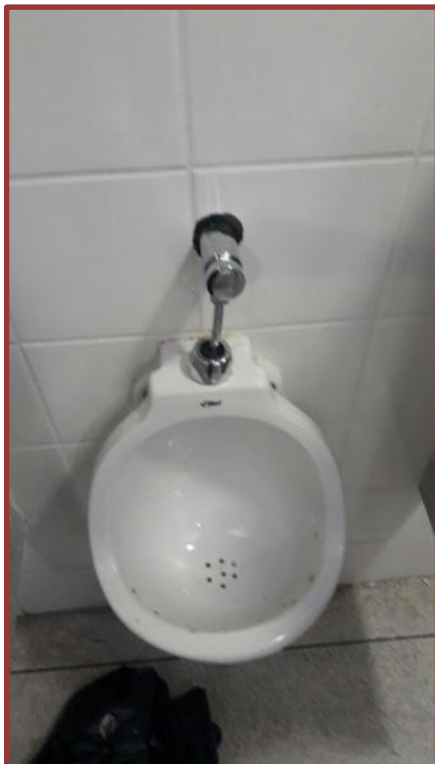
Figura 25 – Regulagem de válvula de mictório em unidade escolar
