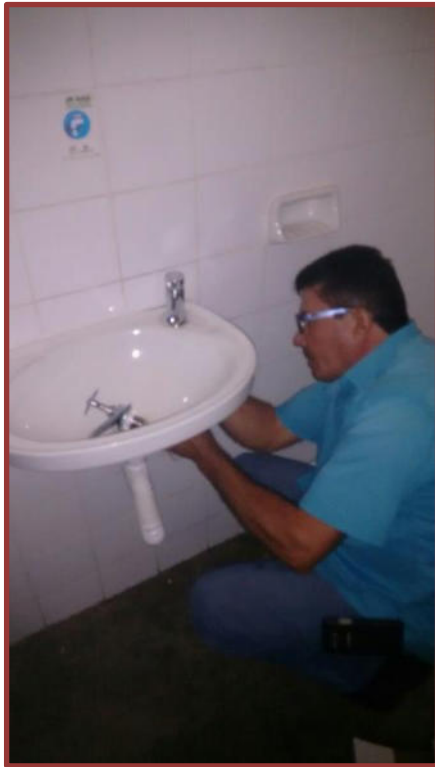
Figura 12 – Instalação de torneira de fechamento automático tipo mesa em unidade de saúde
