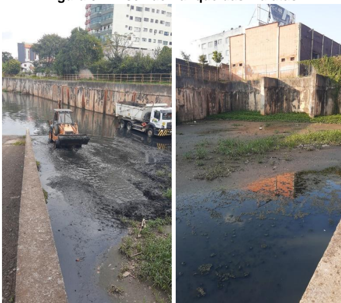
Figura 61: Piscinão Tanque das Mulatas.
