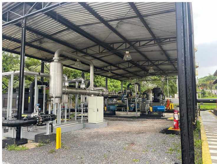
Figura 117: Sistema de aproveitamento do Biogás e geração de energia elétrica.
