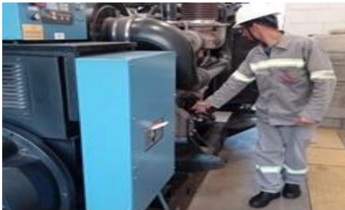
Elevatória Rio Claro – Verificação e manutenção preventiva grupo gerador
