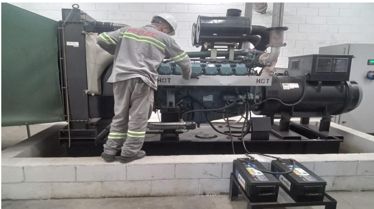
Detalhe do técnico inspecionando o grupo gerador, verificando se há vazamentos na estrutura do motor e verificando encaixes dos cabos e mangueiras
