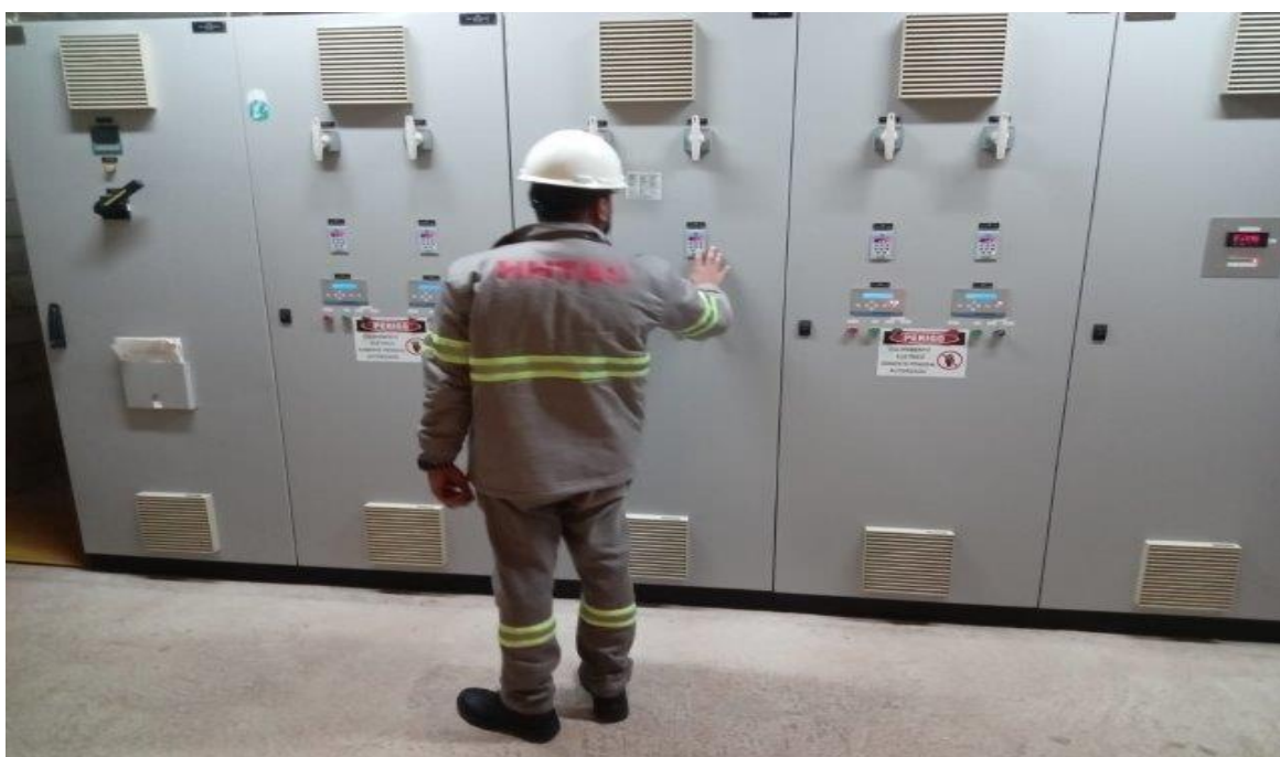
Detalhe do técnico inspecionando cubículos, botoeiras e luzes de sinalização do painel de comando
