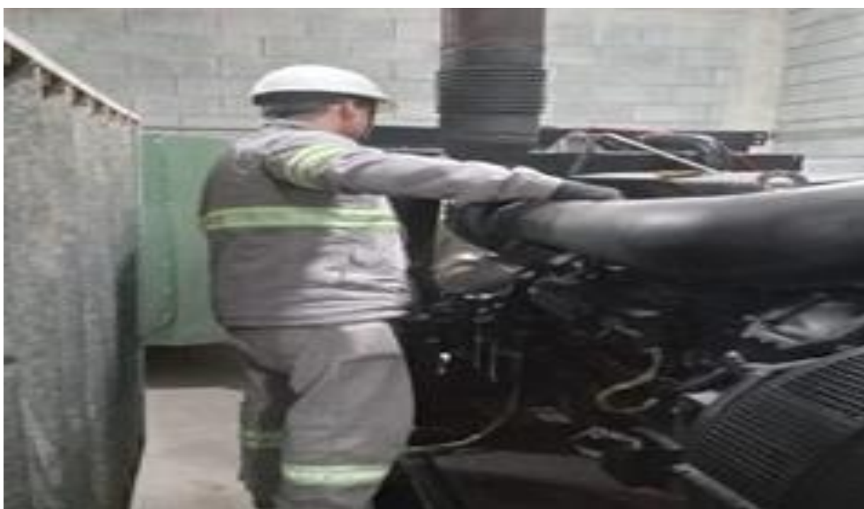
Elevatória Vila Jacquey – Verificação e manutenção preventiva grupo gerador
