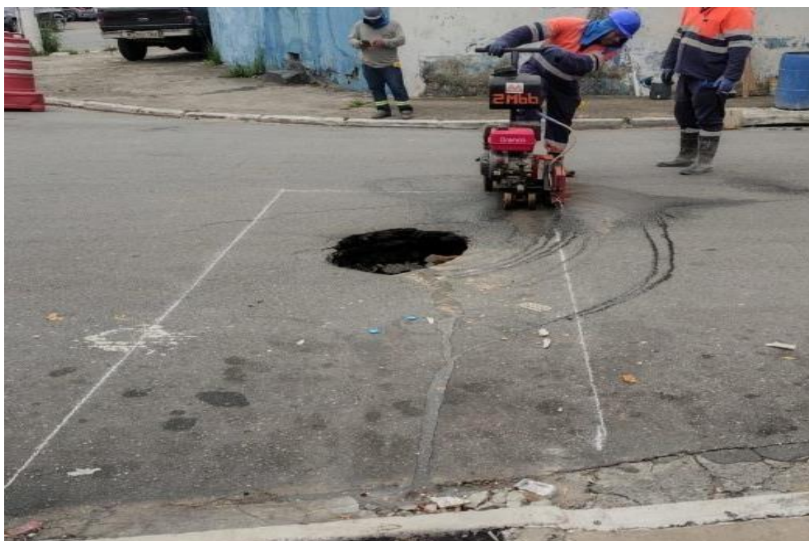
Rua Guilherme de Almeida – Manutenção em tubulação que causou solapamento
