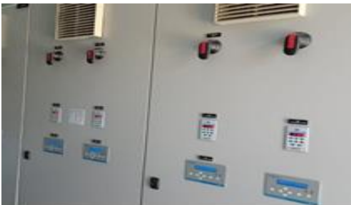
Elevatória Vila Vivaldi – Inspeção e manutenção de Painel de Comando
