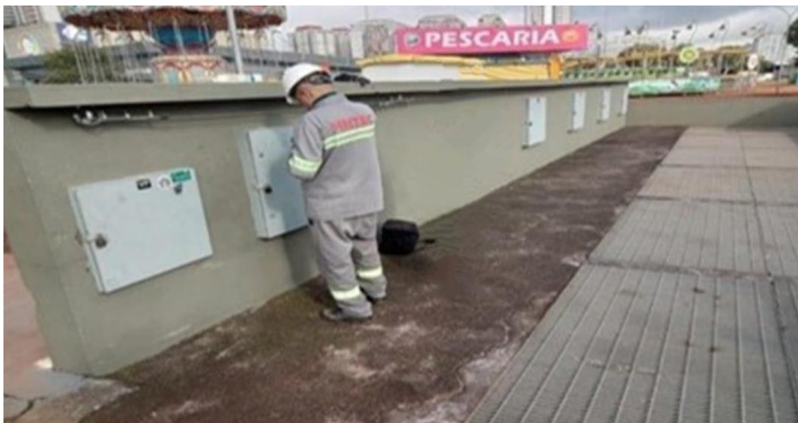
Piscinão do Paço - Técnicos nas dependências do reservatório para realização e verificação das bombas E.E. Ipiranga / Nacional - Retirada da grade de proteção do transformador de média tensão para verificação dos cabos de alimentação e limpeza em e geral
