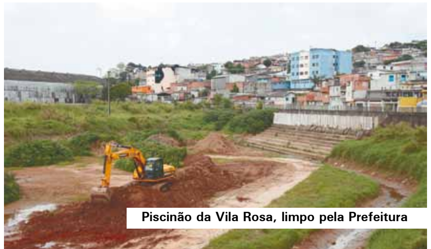
Obra de canalização no Ribeirão dos Couros, onde também será construída nova avenida
