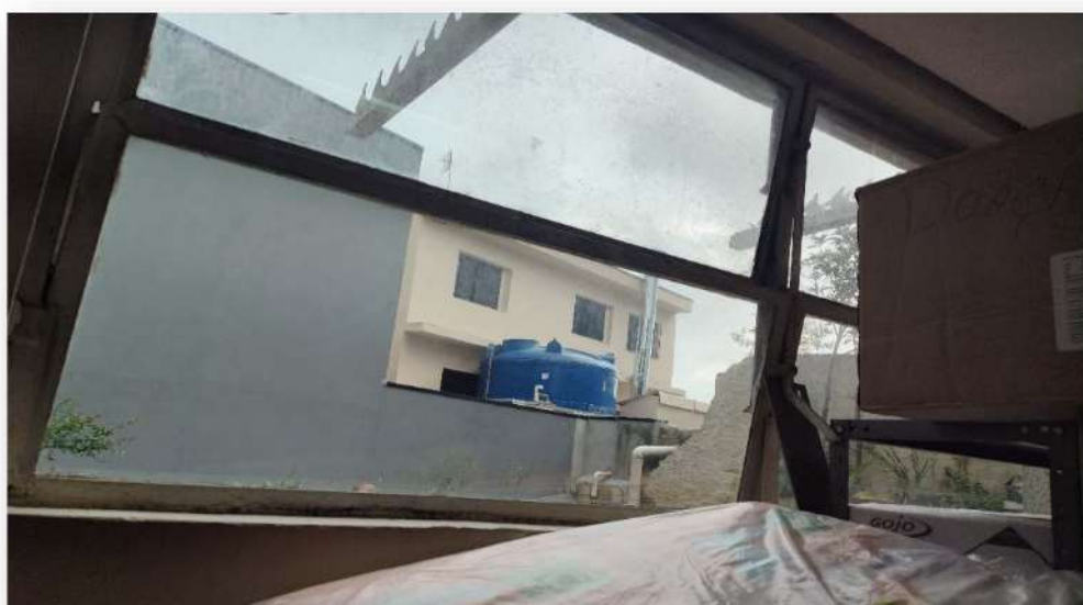
Janela quebrada no almoxarifado
