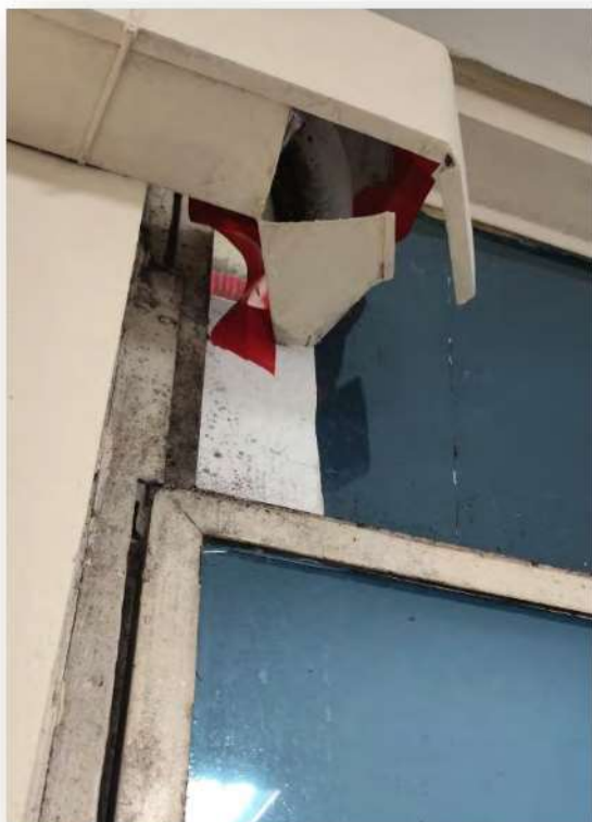
Buraco na janela da farmácia
