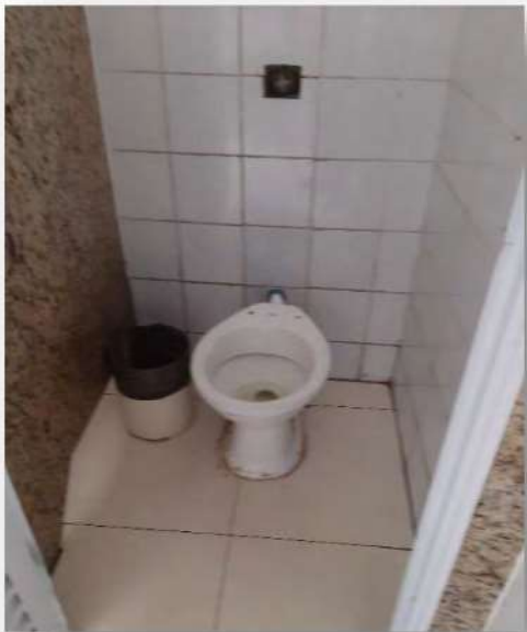
Vaso sanitário sem o assento e sem a tampa frontal para válvula de descarga
